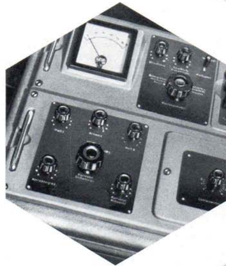
Bedienpult des Verstärkerschrankes
